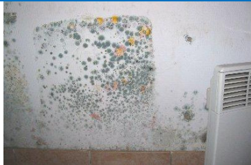
Contaminations fongiques sur un mur
